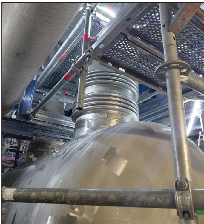
Réservoir classé ESPN (équipements sous pression nucléaire)
