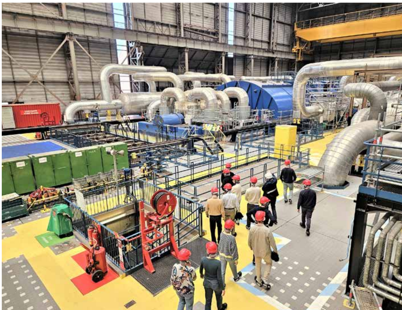
Visite de la salle des machines
