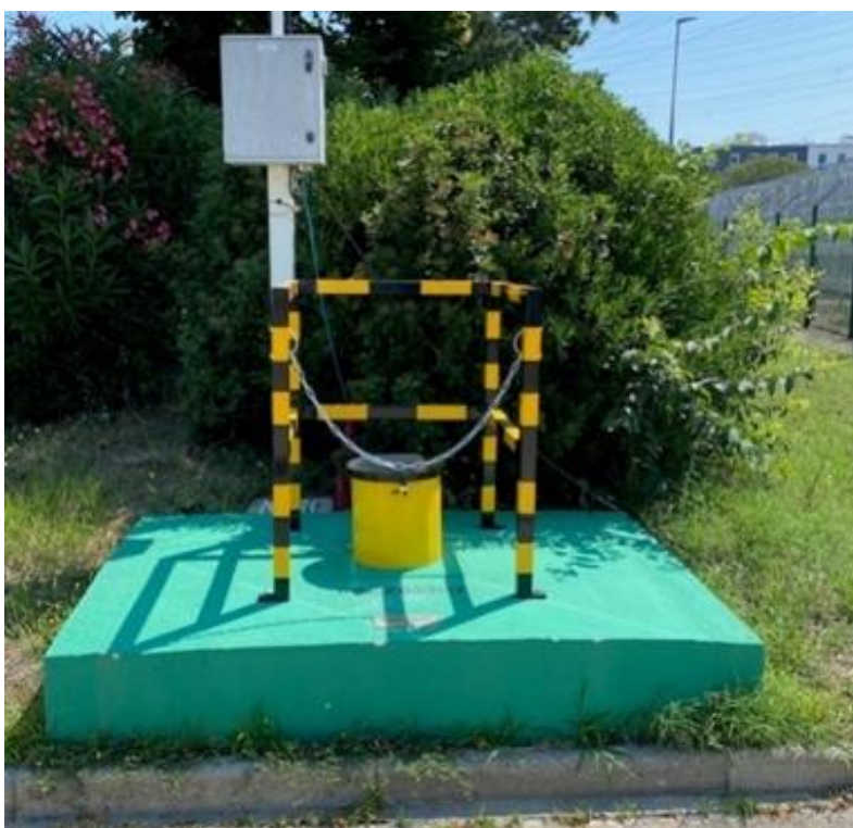
Figure 10: Exemple de piézomètre du CNPE
