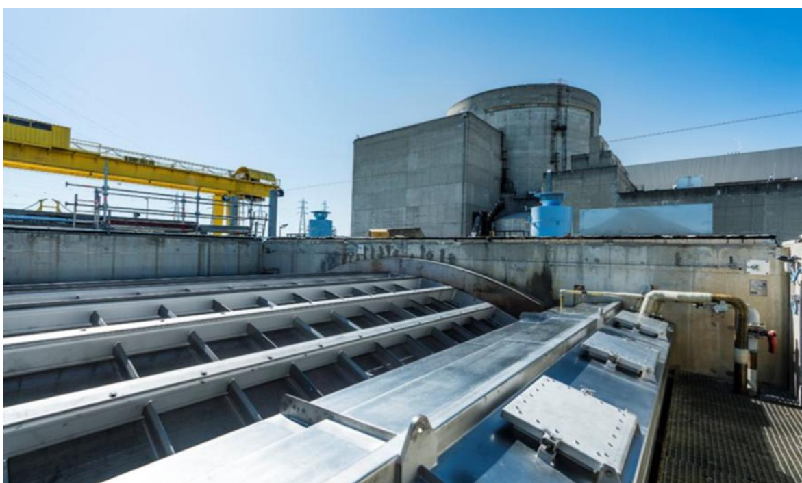
Figure 4: les tambours filtrants du CNPE du TRICASTIN en station de pompage
