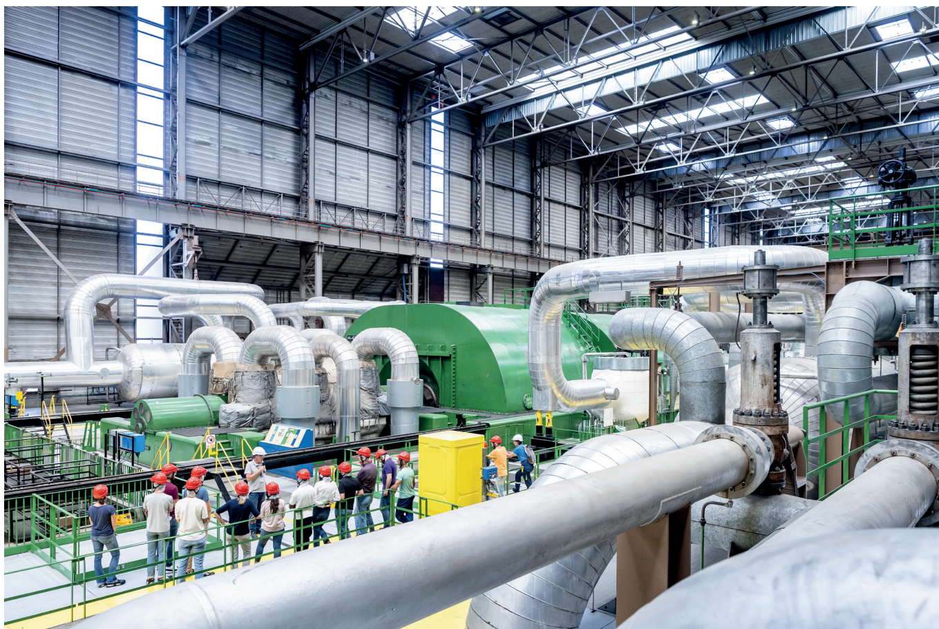
Visite de la salle des machines
