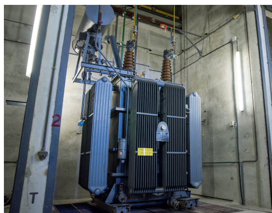
Transformateur dans le poste 63kV de station de pompage
